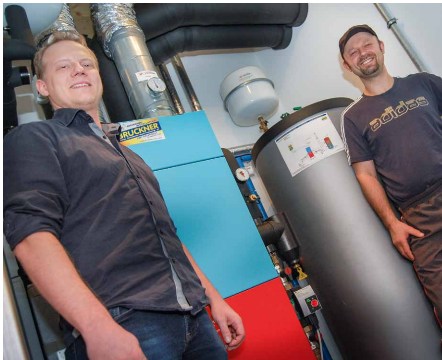
Komplette Haustechnik nach dem letzten Stand der Technik auf kleinstem Raum: Systemheizungsberater Markus Heinrichsberger von Haustechnik Bruckner und Hausherr Hermann Beneder.
