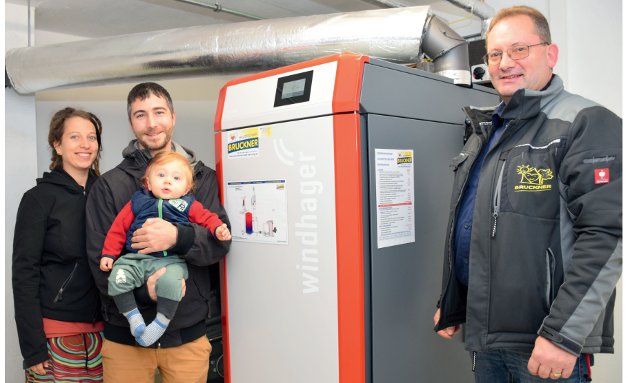
Die neue Windhager Hackgut-Anlage: Der ganze Stolz der Jungfamilie Kogler-Diendorfer. Im Bild mit Heizungsberater Josef Hauer von Haustechnik Bruckner.
