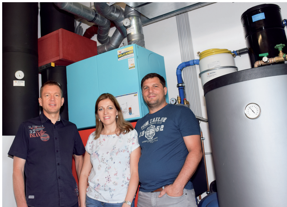
Die Drexel & Weiss Kompaktanlage: Sabine Scheer und Thomas Sanitzer in Purgstall mit Ing. Robert Zellhofer von Haustechnik Bruckner.
