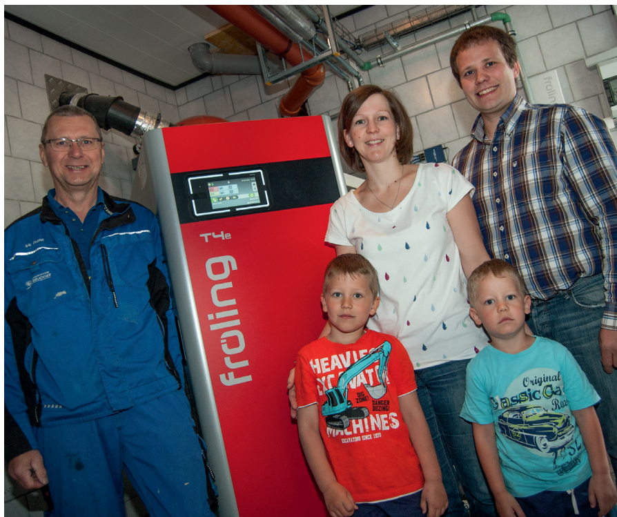
Die Familie Lechner und Obermonteur Franz Irk von Haustechnik Bruckner beim Fröling-Hackschnitzelkessel der neuesten Generation.
